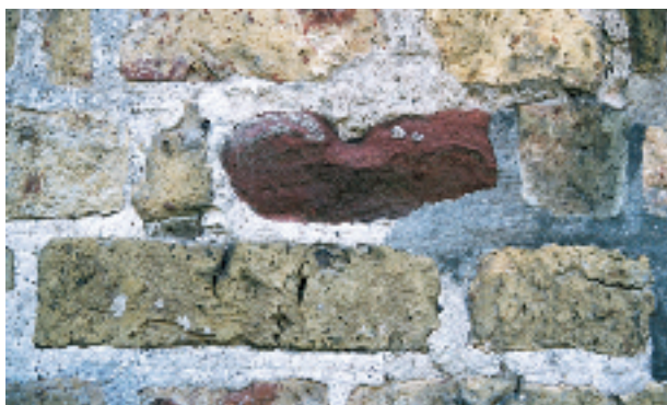
Schraard, beschadigde uitmonding van de piscina
