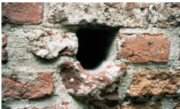
Buitenpost, beschadigde uitmonding van de piscina
