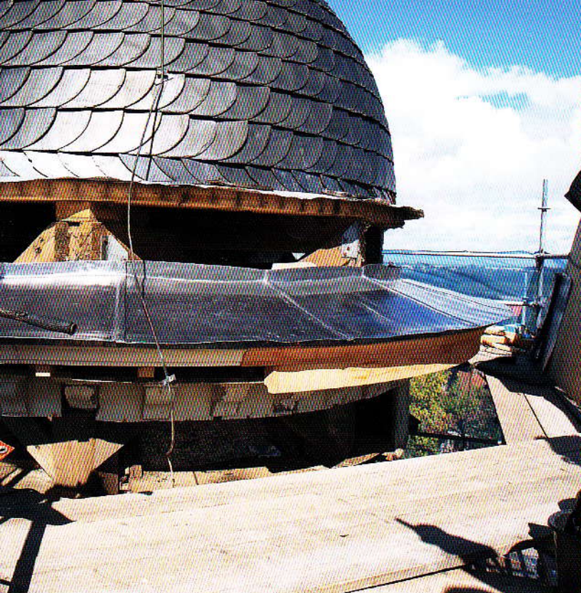
Tijdens de restauratie van de Groate Kerk te Sint Jacobiparochie bleek de lantaarn in slechte staat. Al het lood moest vervangen worden, en grote delen van het hout. Foto: Willem de Graaf
